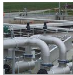
Tratamiento de Agua
